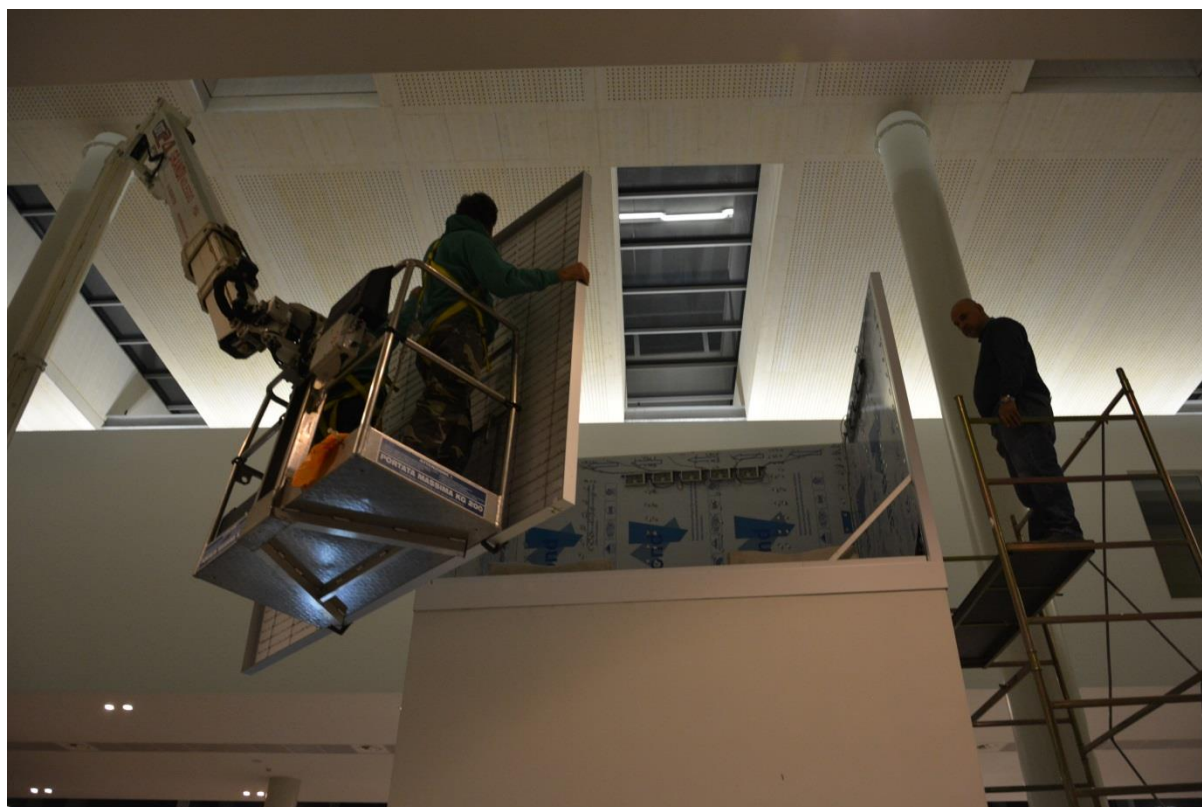
Particolare dell'installazione sulla cima della colonna ascensore.
